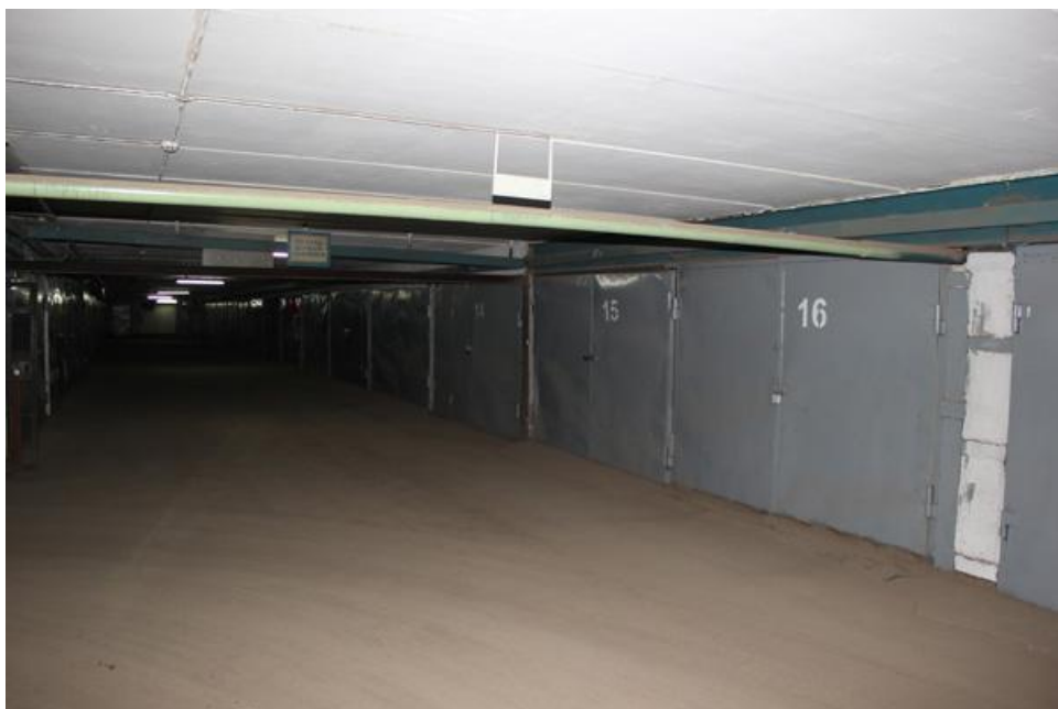
Люминесцентные ЛАМПЫ в проездах ГСК.
